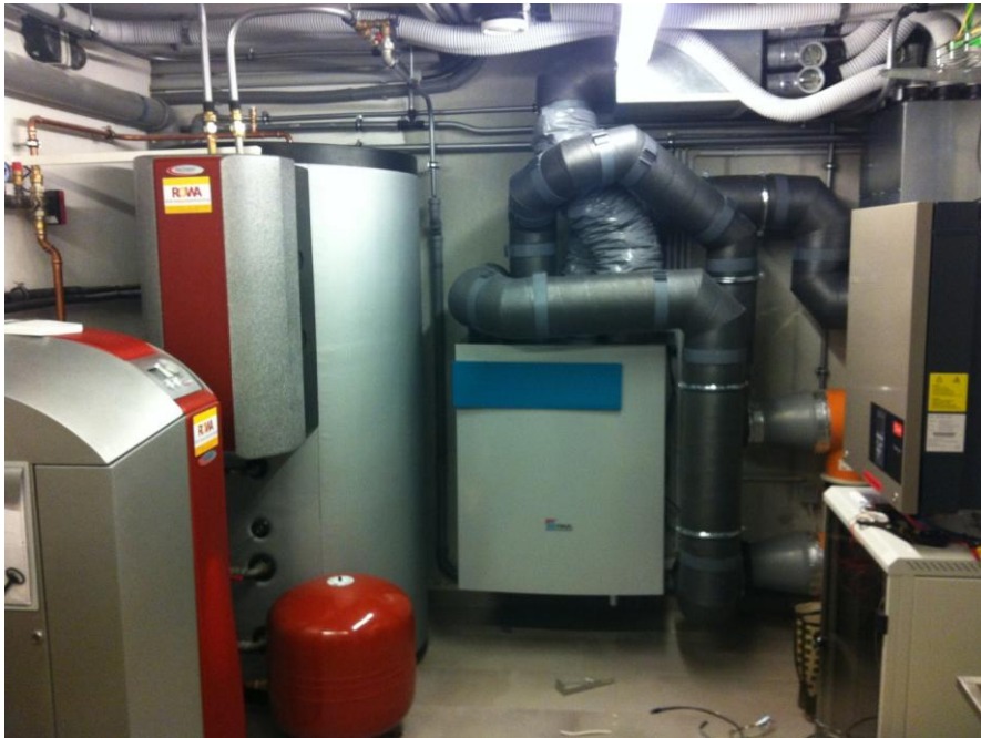
Technikraum mit Wärmepumpe, Komfortlüftung sowie Photovoltaik-Wechselrichter
